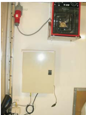
Printerskåp samt värmefläkt
